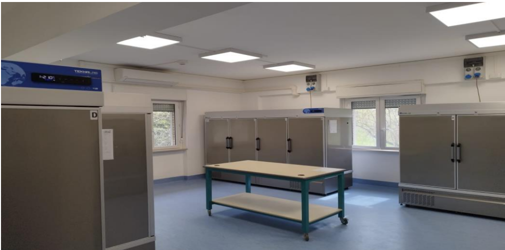
Figure 4. Area fredda con vista banche refrigeranti.
